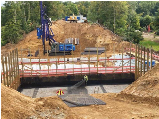
Bild 9 Verlegen der ersten Lage der Geogitterbewehrung der L 182 über den Swistbach, 04.10.2021 Laying of the first layer of geogrid reinforcement for the abutment of the Swistbach Bridge along the regional road L 182; Oktober 4, 2021
