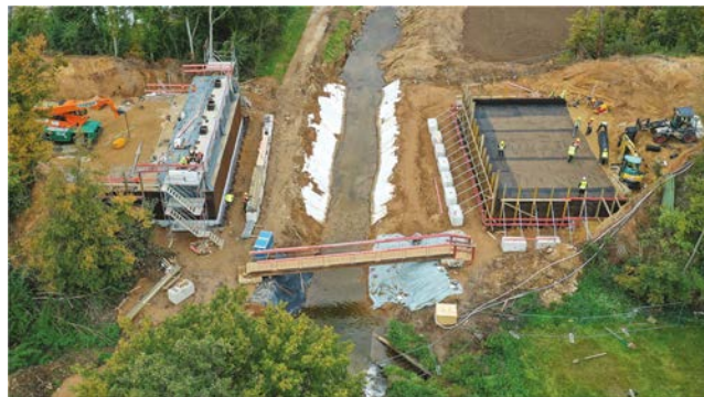
Bild 10 Stand der Arbeiten an der L 182 über den Swistbach zum 14.10.2021 Status of work as of October 14, 2021, on the Swistbach Bridge along the regional road L 182
