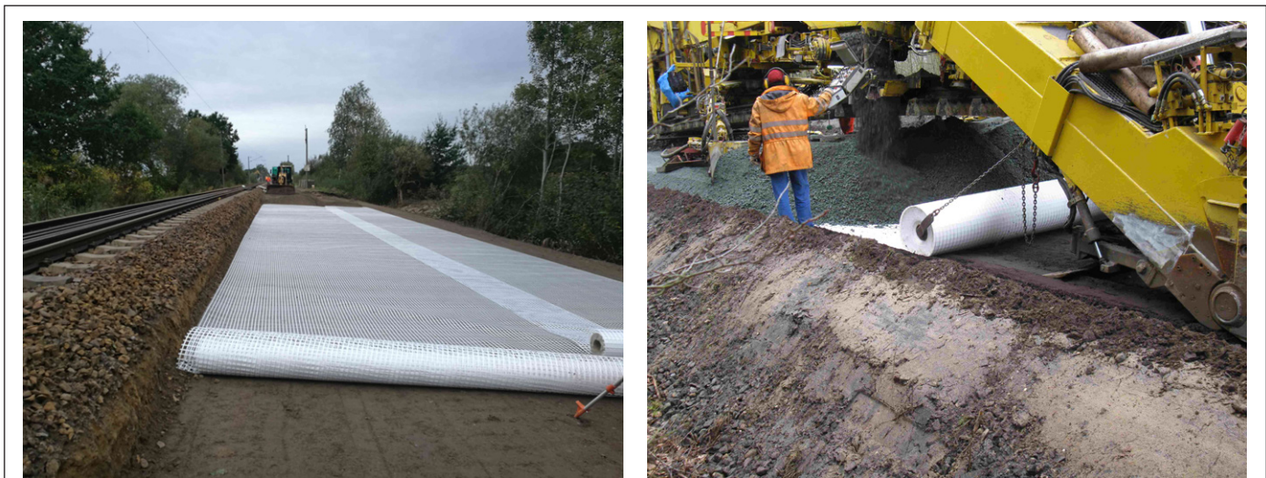
Abb. 3: Einbau von Geoverbundstoffen unter Schutzschichten konventionell gleislos (links) bzw. gleisgebunden mit einem Gleisumbauzug (rechts)
